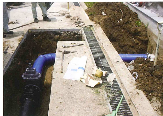
配水池の可とう管、側溝の下越し、および曲管として使用
