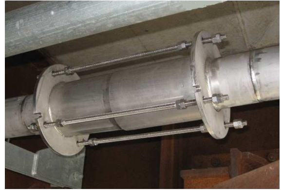
φ 150RTLS 桁内添架管で使用
