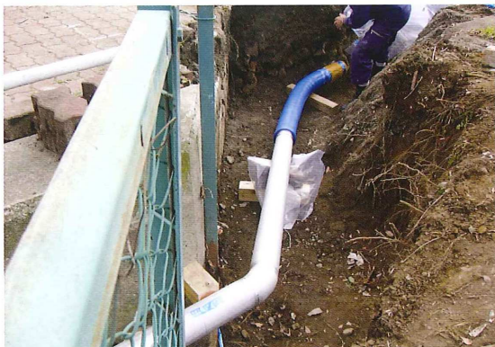
ステンレス水管橋の埋設部に可とう管として使用
