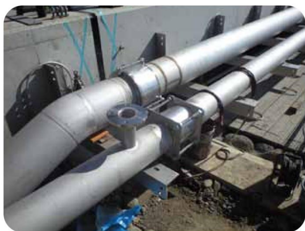
橋梁添架部での伸縮管として使用
