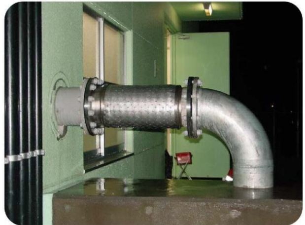
構造物取出後、伸縮可とう管として使用
