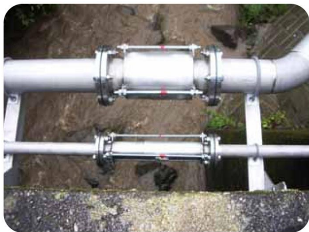
橋梁添架部での異口径二条管路
