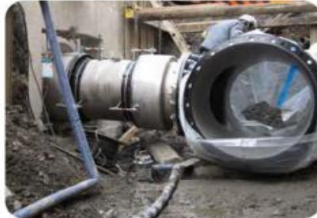
構造物とT字配管の間に 可とう管として使用
