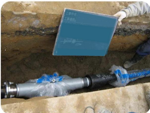
水管橋埋設部にて伸縮可とう管として使用
