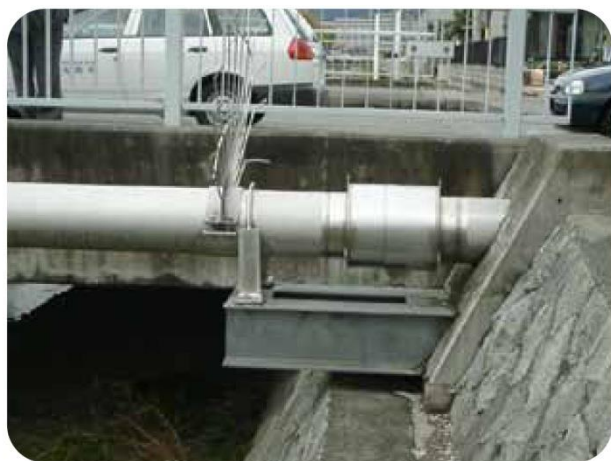
橋梁添架部での伸縮管として使用
